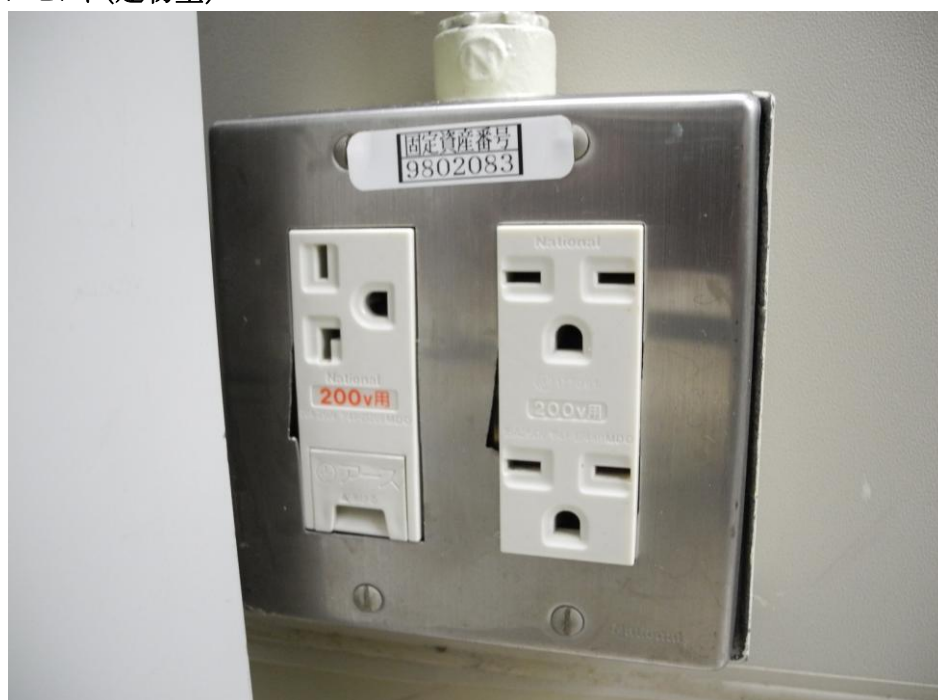
コンセント(建物壁)
