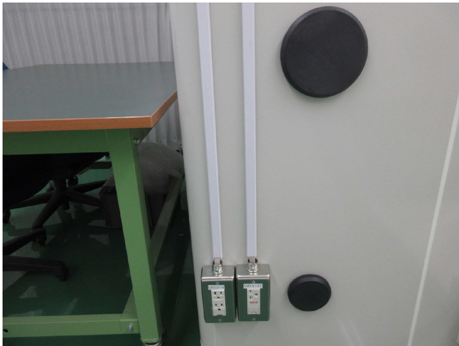
前面（ケーブル孔/コンセント）
