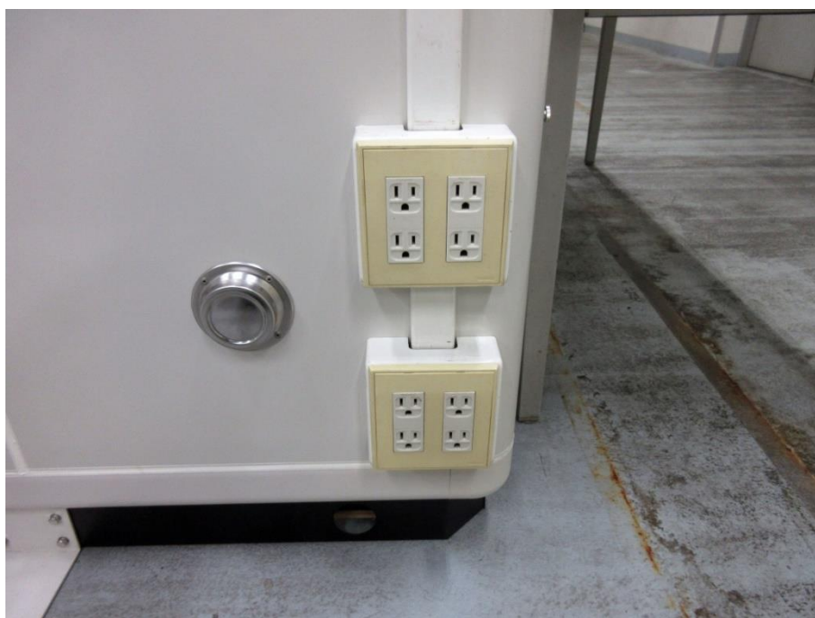
前面（ケーブル孔/コンセント）
